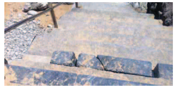
Peldaño suelto en las escaleras de acceso a esta playa llanisca. :: E. C.
